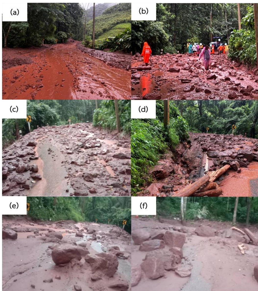
ภาพ 2 เหตุการณ์ดินโคลนถล่มปิดทับเส้นทางหลวงหมายเลข 1081 บ่อเกลือ-เฉลิมพระเกียรติ จังหวัดน่าน ช่วง กม.: 97+225 ถึง กม.: 97+275 เมื่อวันที่ 2 และ 12 สิงหาคม พ.ศ. 2567 (a-f) ลักษณะทางกายภาพของดินโคลน
