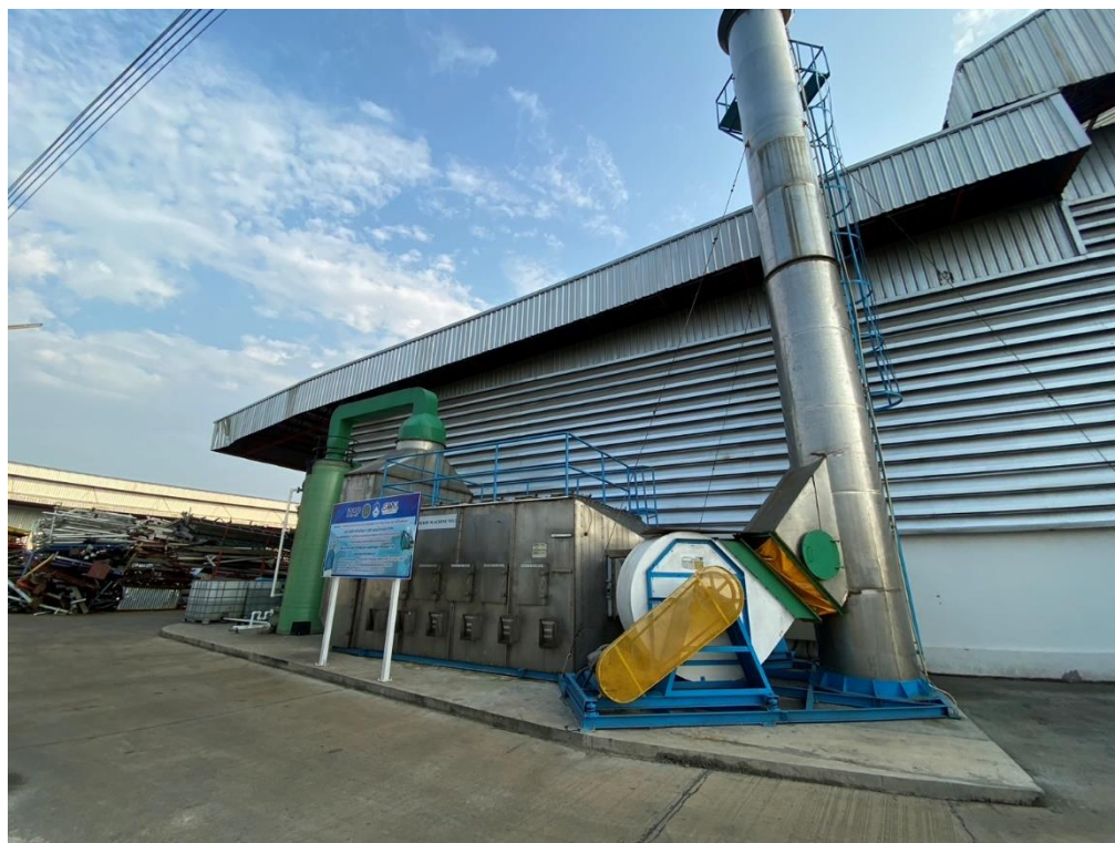
ภาพ 36 WET SCRUBBER
