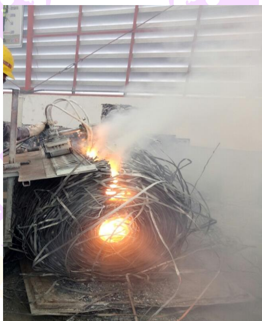
ภาพ 29 ลักษณะควันจากการตัดเหล็กม้วน
